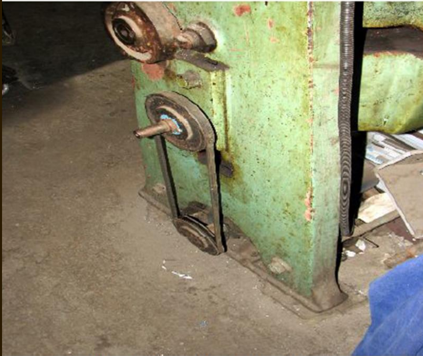
Védőburkolat nélküli ékszíjhajtás
