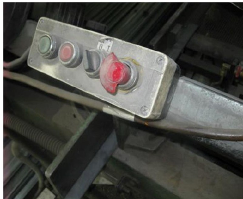
Szalagfűrész kezelőpanel törött vészleállító gombbal.
