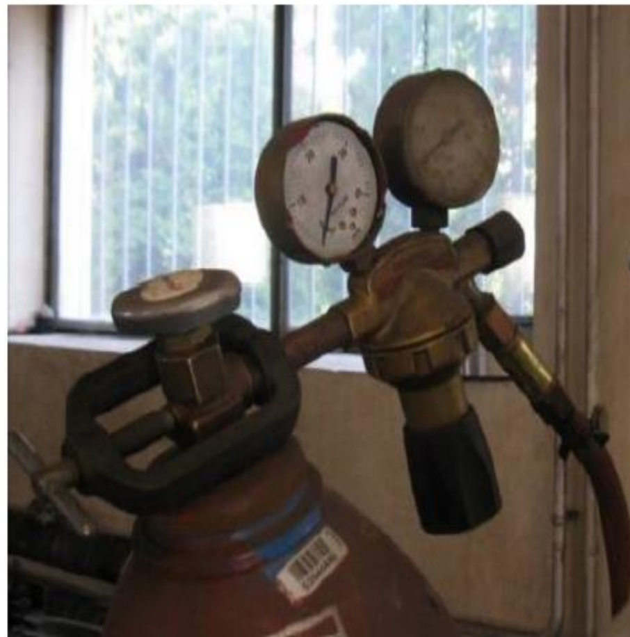
A nyomásmérő üvege hiányzott
